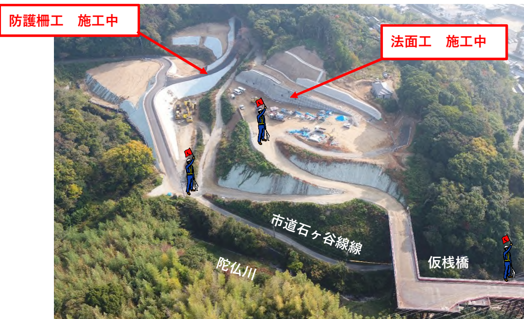
状況写真(撮影日：R4.11.11)
