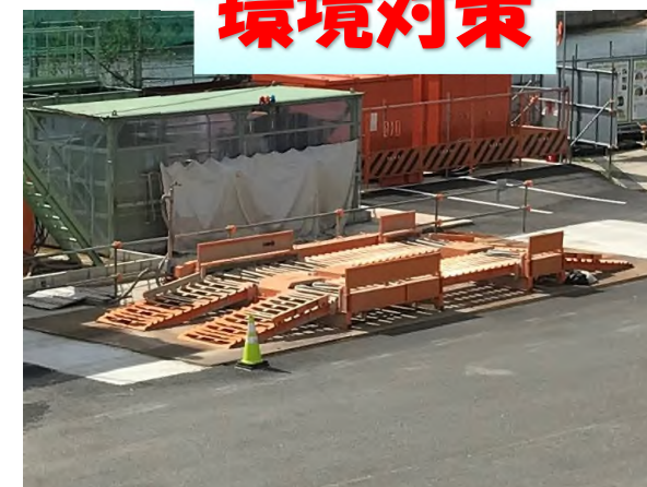
仮設備工 タイヤ洗浄装置
